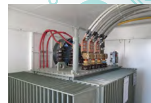
CABINE DI TRASFORMAZIONE
